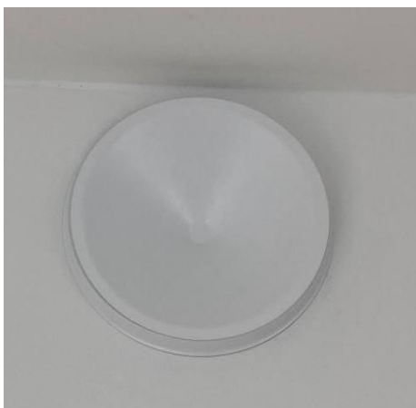
Indblæsningsarmatur i rum (kun rækkehuse)
