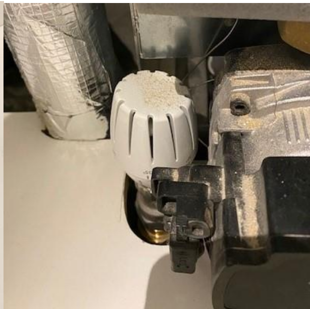
Fremløb gulvvarme (Er indreguleret) Bør kun reguleres Hvis vi får en rigtig streng vinter
